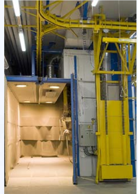
Robottipuhaltamo ja kattokuljetin.
